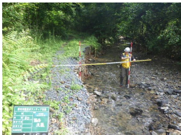
石積沢林道（路体洗掘）
