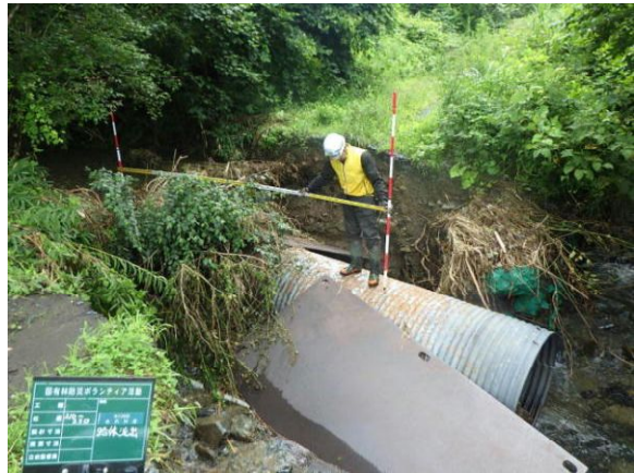
水沢林道（路体流出）
