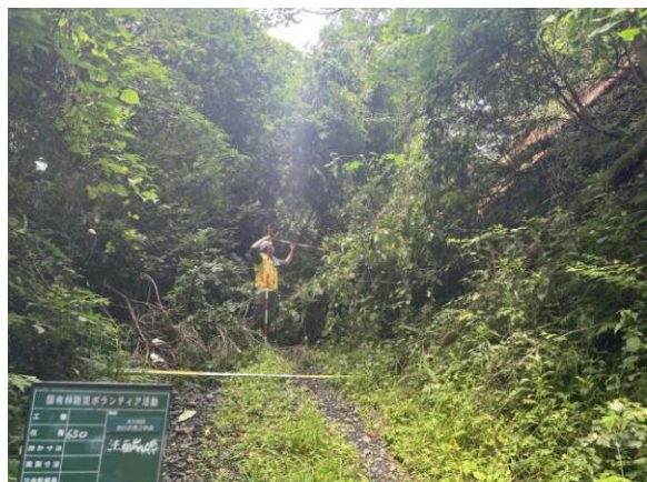
岩の沢第2林道（法面崩落）
