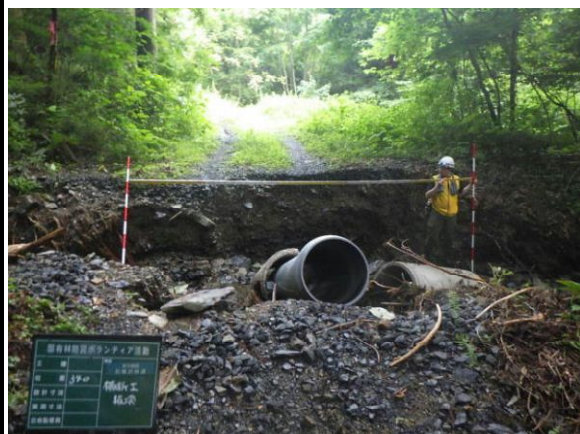
岩の沢第2林道（横断工損傷）
