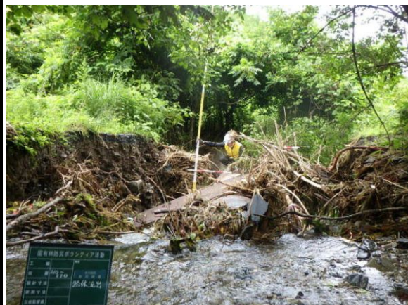
水沢林道（路体流出）
