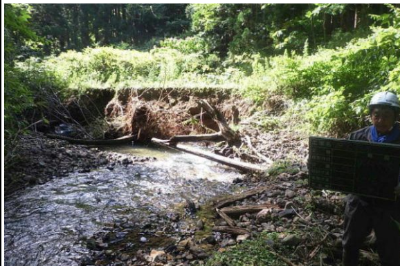
母沢林道（路肩決壊）
