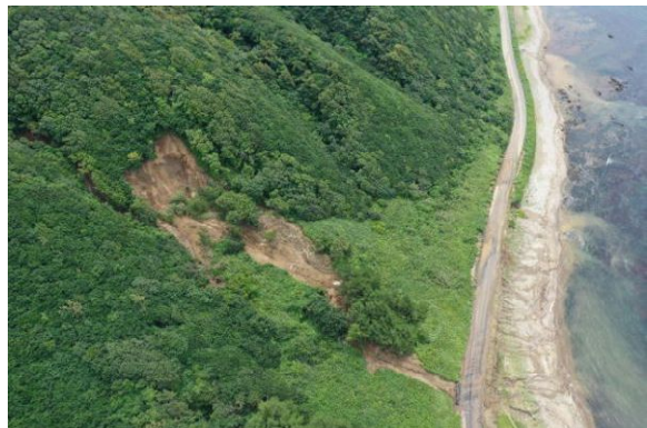
山腹の崩壊（写真：金木支署提供）
