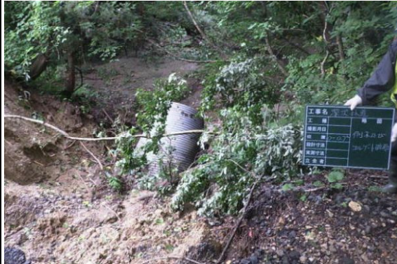
深沢林道（倒木及びコルゲート破損）
