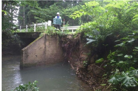
金平林道（金平橋路肩崩壊）
