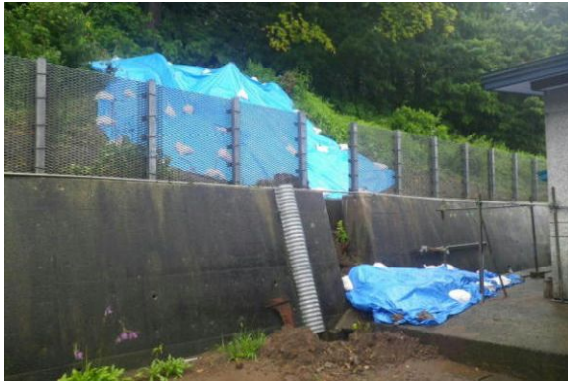
平舘地区（法面崩壊）
